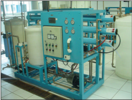
Sistema de membranas de osmose reversa, utilizado para dessalinizar a água
