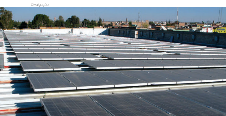
Os painéis solares ocupam mais de 2 mil m 2 do teto da loja de Aguascalientes
